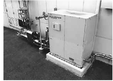
地中熱ヒートポンプ(室外機)
