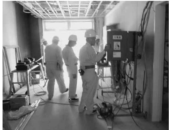
分電盤安全チェック
